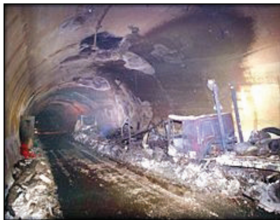
Figuur 6.3: Uitgebrande wrakken in de Mont Blanc Tunnel (33).
