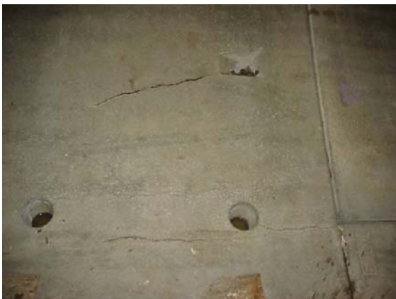
Figuur 37: Scheurvorming t.p.v. de conusgaten en boutpockets
