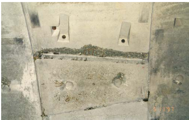
Figuur 29: Betonschade t.p.v. voeg sluitsteen
