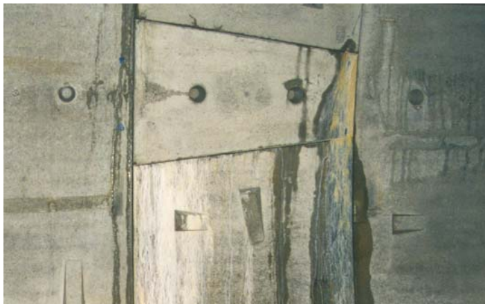
Figuur 38: Voeglekkage t.p.v. de sluitsteen
