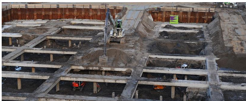
De rondleiding voert onder andere langs de Markthal, een prestigieus project waar Martens en Van Oord meewerkte aan de fundering en ondergrondse parkeergarage. (Foto: VIA MARTENS EN VAN OORD )
