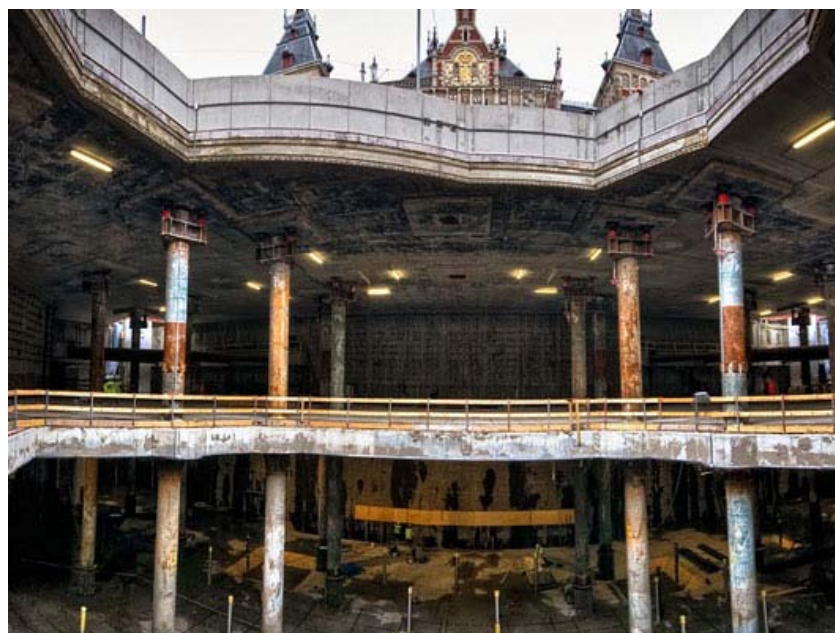
Werken aan het metrostation onder het voorplein van Amsterdam Centraal. (Foto: Dienst Noord/Zuidlijn)
