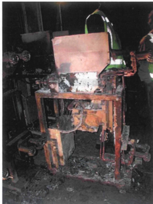
Afb. 9. De verbrande hoogspanningsschakelaar in station Schiphol
