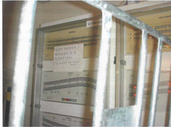
Afb. 10 Het synoptisch tableau in een kantoor op Schiphol. Op het papiertje op het tableau staat of men geen karretjes voor het tableau wil plaatsen op verzoek van de brandweer. De schakelruimte is nog steeds niet voorzien van een brandmelder
