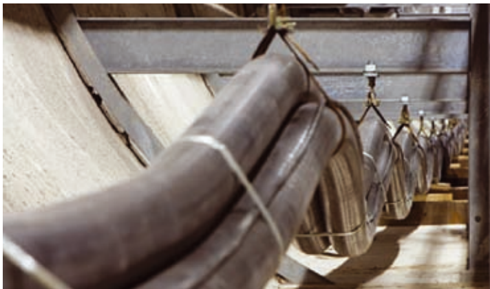
Afbeelding 5.10 150 kV kabels in Leidingentunnel Oude Maas 'Gesnaked' opgehangen
