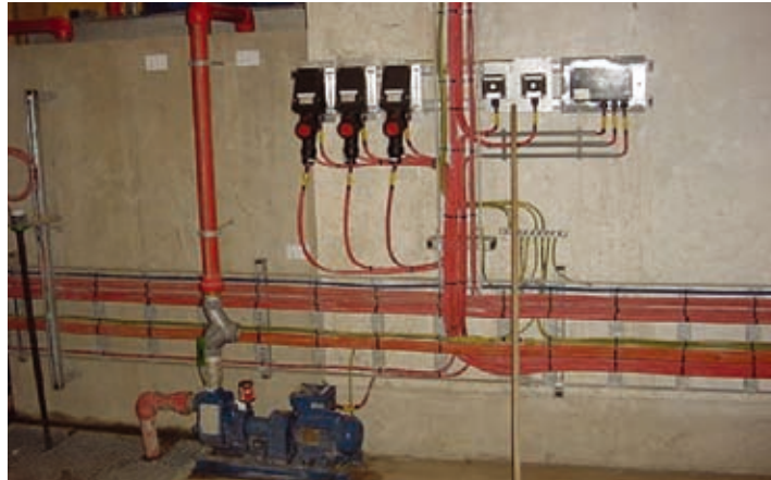
Afbeelding 7.7 Bekabeling TTI Calandtunnel
