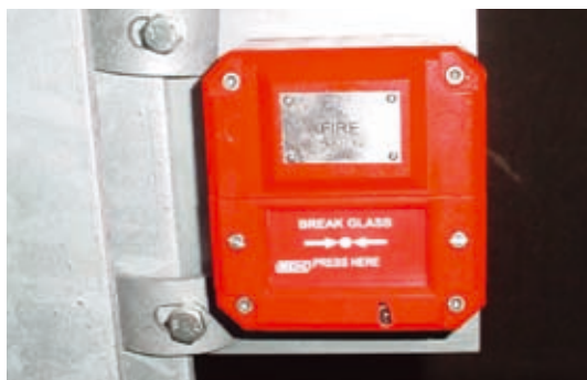
Afbeelding 7.5 Handmelder in Calandtunnel
