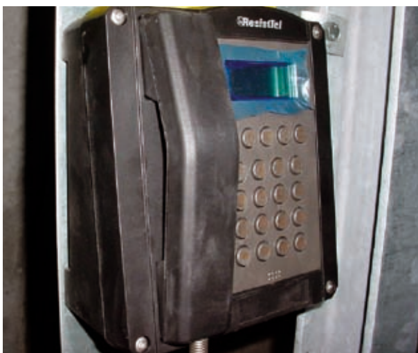
Afbeelding 7.4 Telefoon in Calandtunnel
